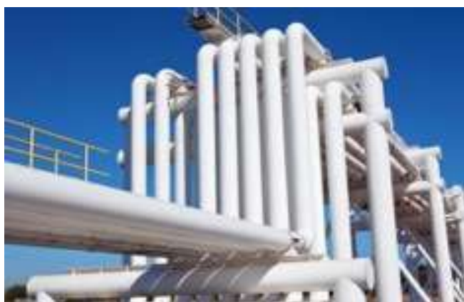
Нефтепереработка, нефтехимия, СПН
