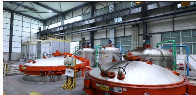
Автоматизированный участок для вакуумной пропитки эпоксидным ангидридом VPI
