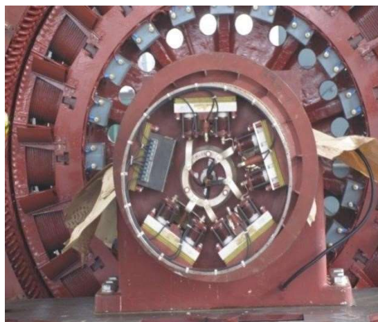
Вращающееся выпрямительное устройство
