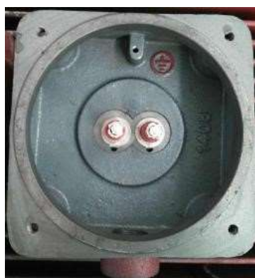
Вид внутри коробки выводов обогревателя
